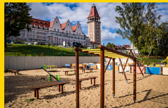
Remont placu zabaw za domem rybaka – Budowa placu zabaw na terenie Letniej Estrady Koncertowej we Władysławowie
