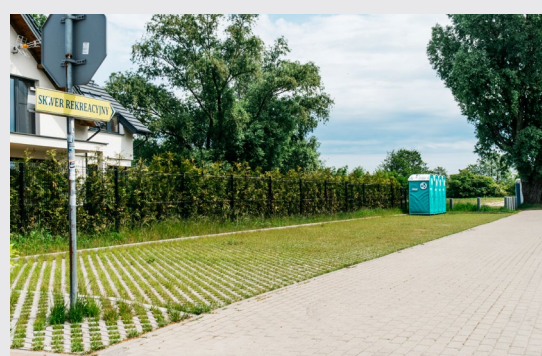
Wykonanie utwardzenia na działce gminnej nr 770/2 przy Skwerze nad Zatoką we Władysławowie
